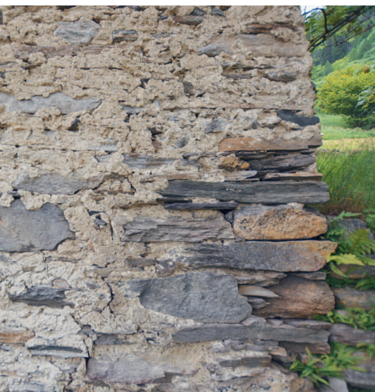
Der ehemalige Stall ist aus Bruchsteinen gemauert und war mit Kalk verputzt.
